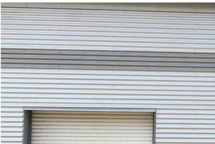
Misstand: Materialität der Fassade
