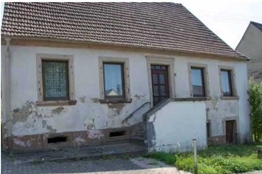
Denkmalgeschütztes leer stehendes Wohngebäude im Bereich der Straße „Zum Storckelborn“ mit Sanierungsbedarf
