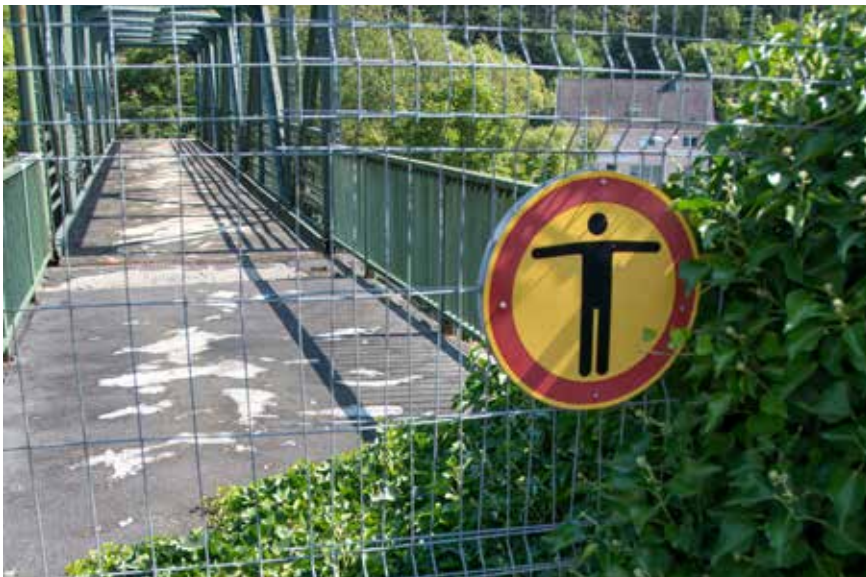
Gesperrte Fußgängerbrücke im Bereich des Bahnhofes Wustweiler
