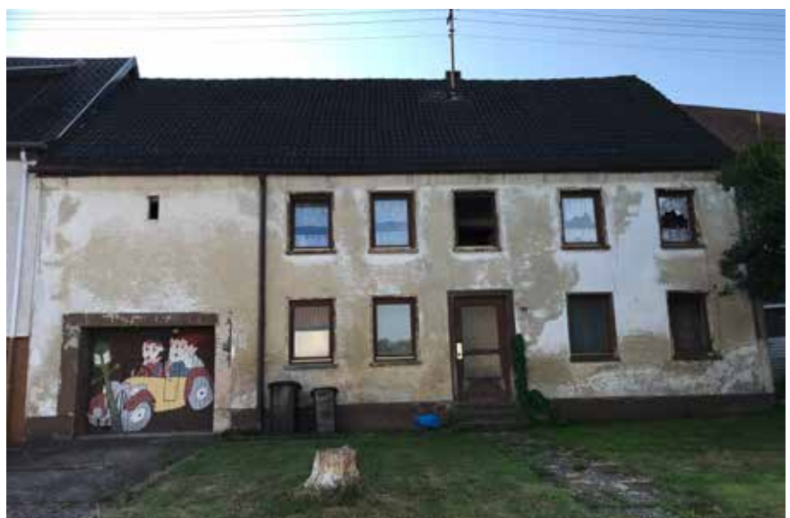
Einhaus in der Humeser Straße mit Sanierungsbedarf
