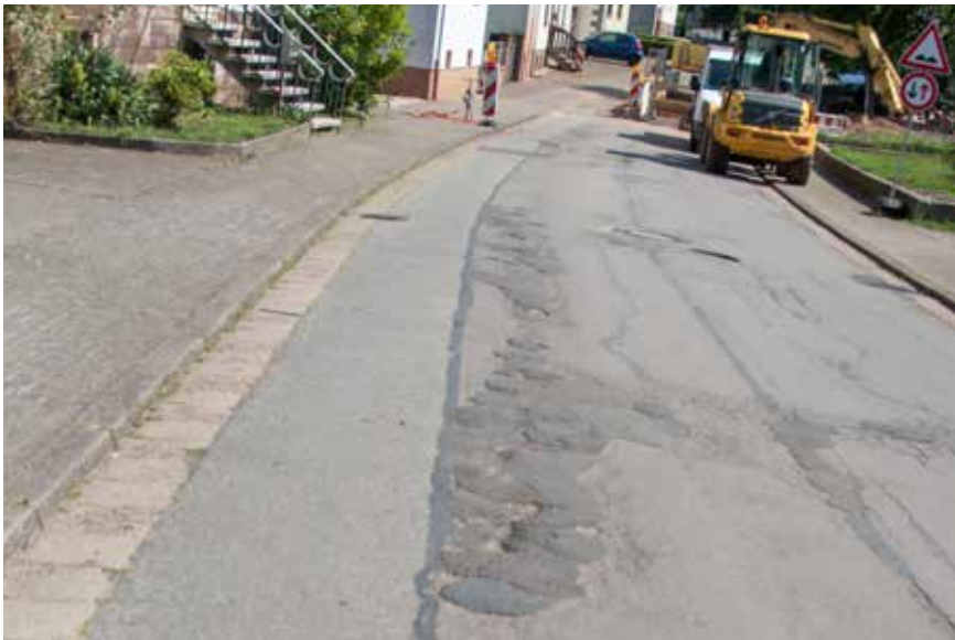
Sanierungsbedürftige Fahrbahndecken in der Humeser Straße
