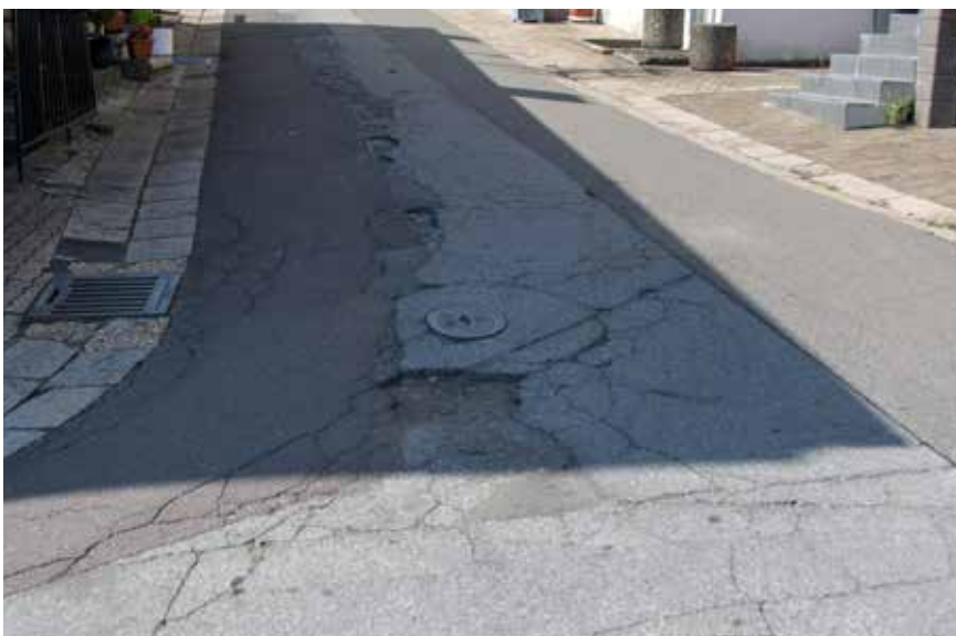
Sanierungsbedürftige Fahrbahndecken in der Butterbergstraße
