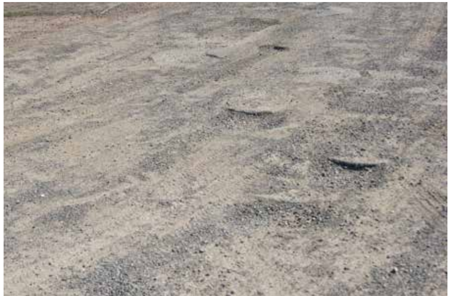
Befestigung des P&R-Parkplatzes am Bahnhof mit Erneuerungs-/Ausbesserungsbedarf
