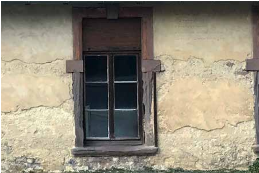
Modernisierungs- und instandsetzungsbedürftiges Gebäude mit hohem Bedarf
