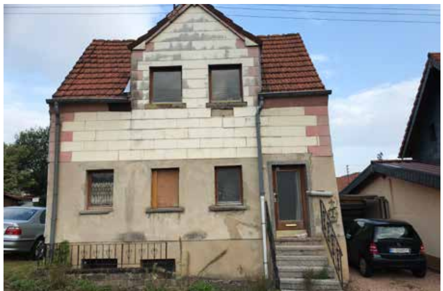
Leer stehendes Wohngebäude in der Butterbergstraße mit Sanierungsbedarf
