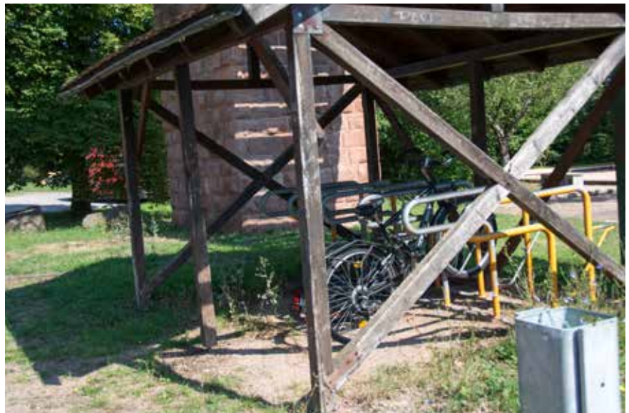
Fahrradstellplatz am Bahnhof mit Erneuerungsbedarf
