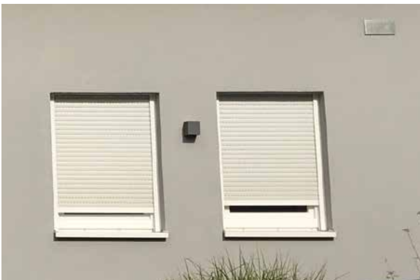
Modernisierungs- und instandsetzungsbedürftiges Gebäude mit geringem Bedarf
