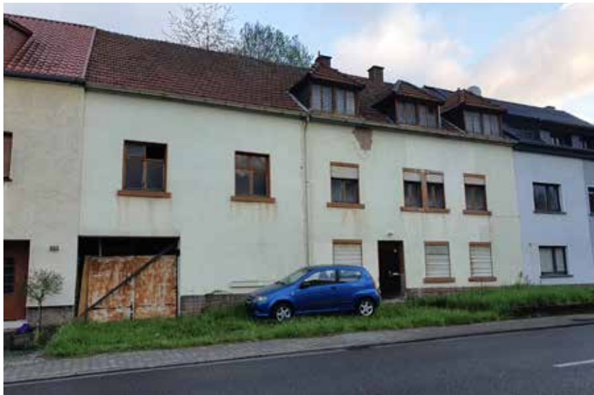
leer stehendes Gebäude mit Sanierungsstau in der Provinzialstraße (L 141)
